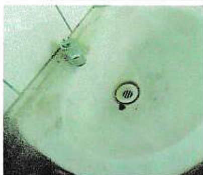
Foto 9: Ejemplo de grifo dañado en lavamanos de mujeres.
