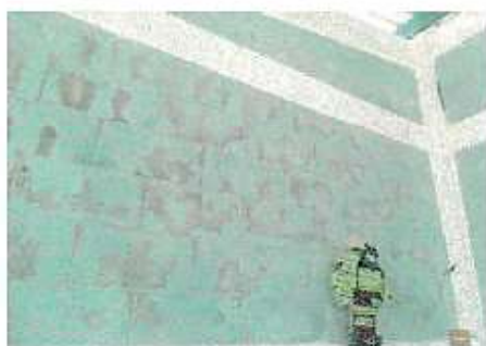
Foto 3: Ejemplo de daño en pintura dentro de la direccion. Causada por humedad.
