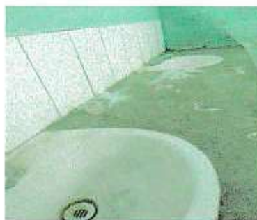
Foto 10: Ambos grifos dañados. Baño de mujeres
