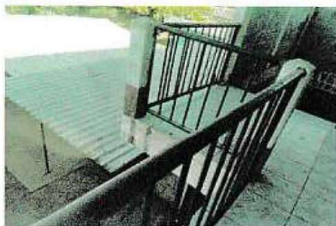
Foto 11: Barandael con muestras de oxidación. Junto a gradas.
